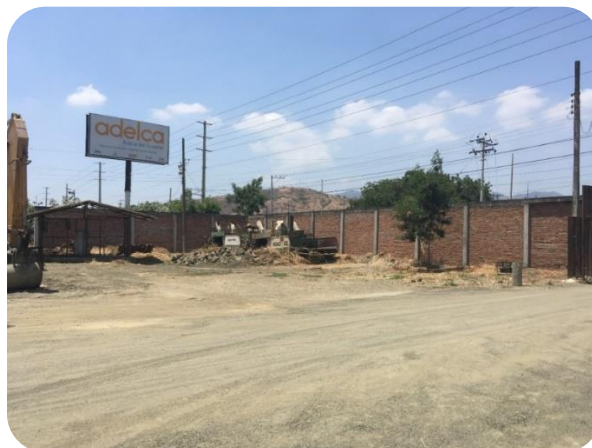
Imagen 19: Espacio físico de la Compañía COCIASA S.A donde se construirá la nueva edificación
