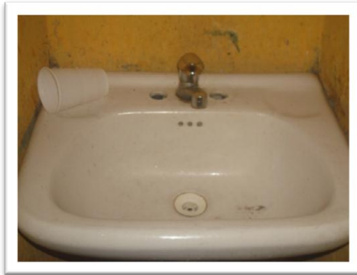
Foto 16 Lavador de manos baño caballeros restaurante Herminia.
