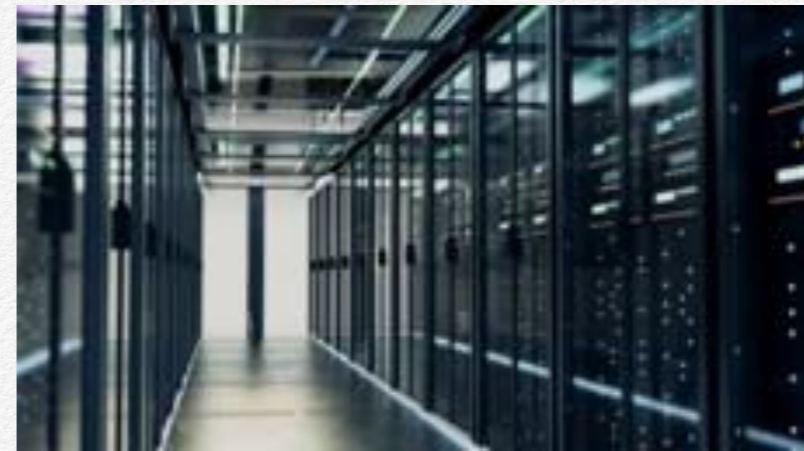
Imagen 144: Rack de telecomunicaciones.
