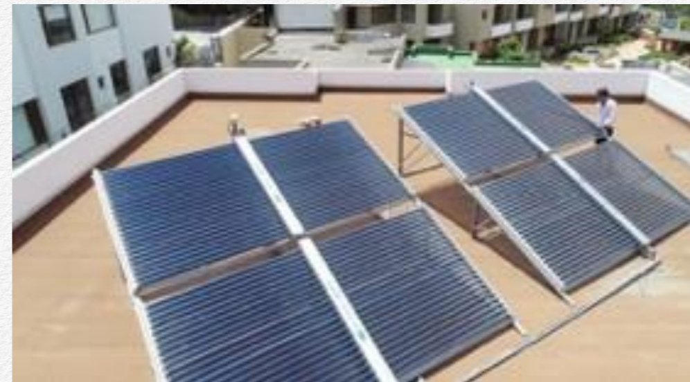
Imagen 116: Paneles solares utilizados en edificaciones.
