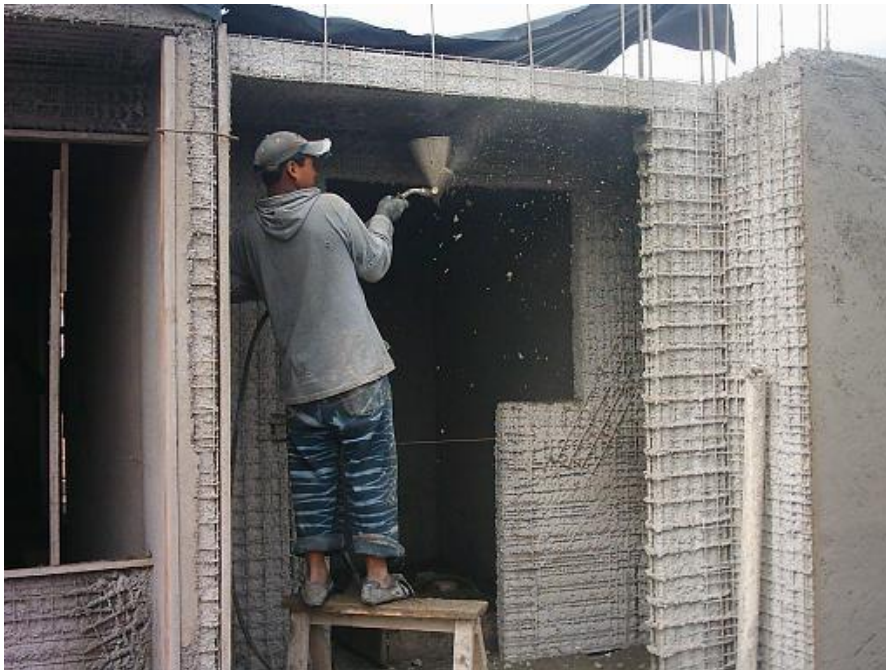
Ilustración 35. Mortero en cara inferior de losa
