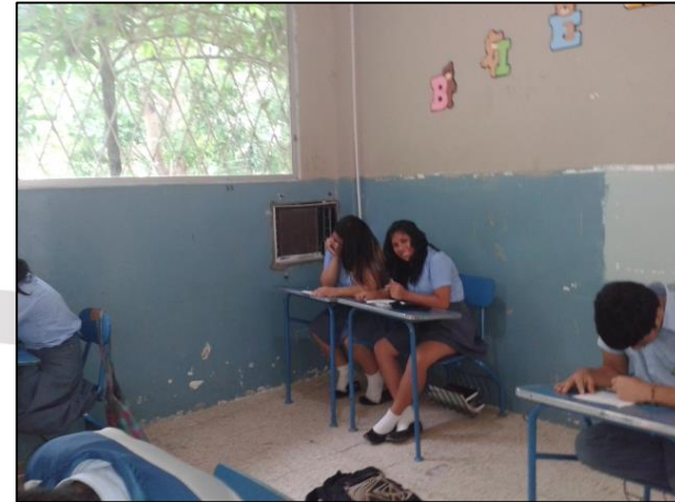
Imagen 39. Aire acondicionado mal ubicado.
