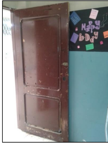
Imagen 37. Puerta de madera deteriorada.
