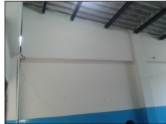
Imagen 36. Paredes en mal estado. Fuente: Elaboración propia
