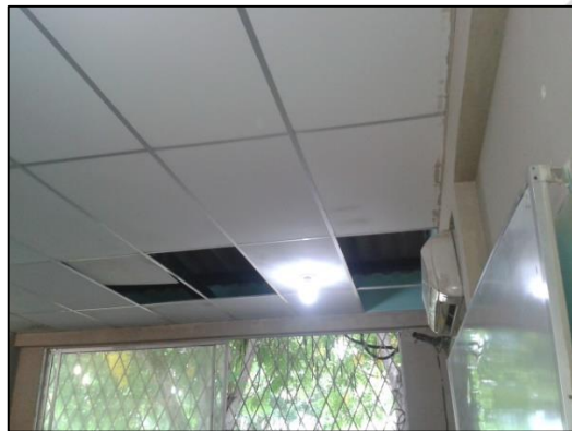
Imagen 35. Tumbado en mal estado. Fuente: Elaboración propia.
