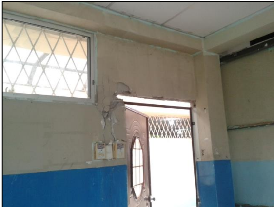
Imagen 38. Puerta de metal en mal estado.
