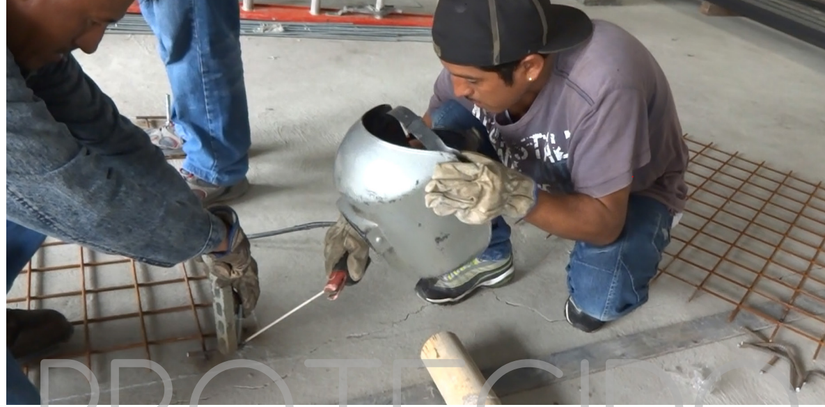
IMAGEN 213: Preparación de la pieza en sitio antes de soldar Fuente: Realizado por Denisse Aguilera
