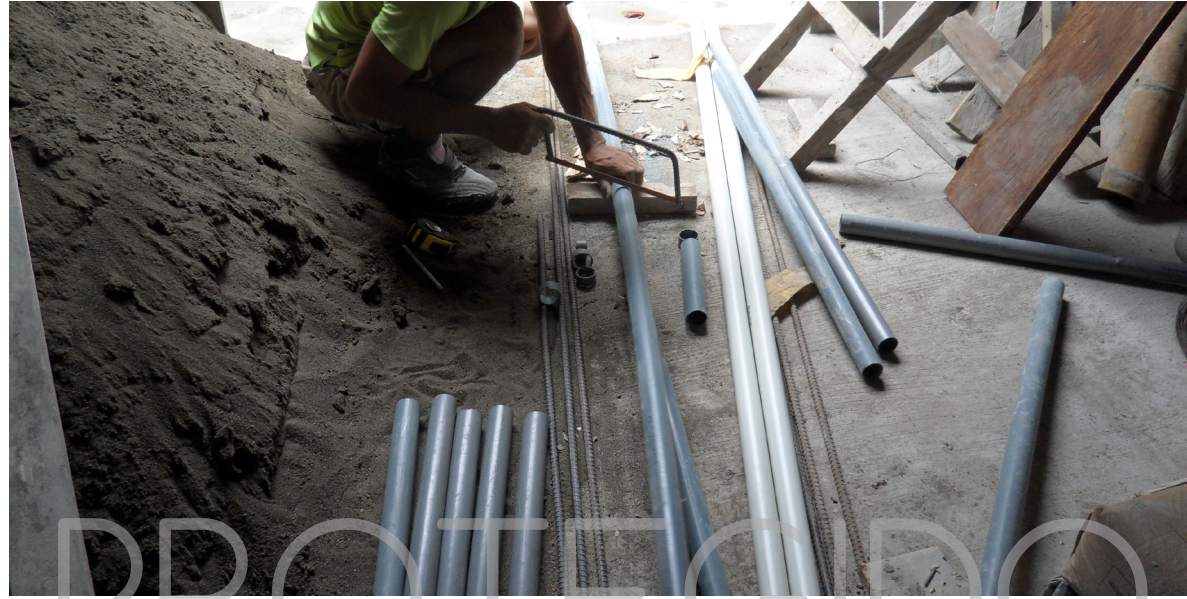
IMAGEN 223: Corte de los tubos por medio de sierra normal Fuente: Realizado por Denisse Aguilera
