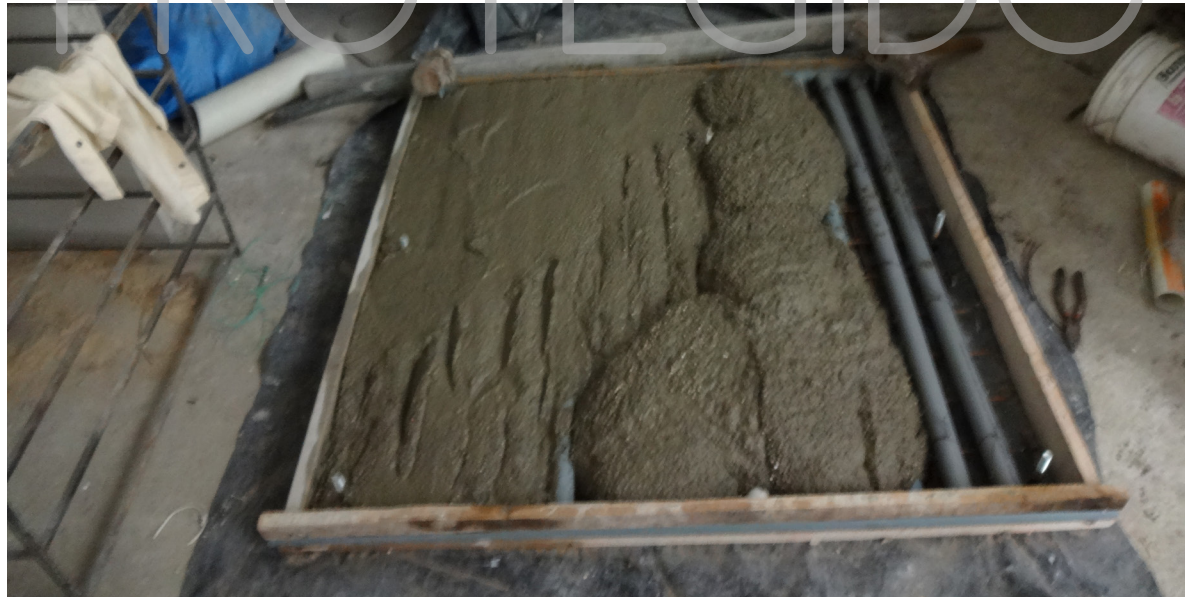
IMAGEN 236: Encolado de la mezcla en la pieza de encofrado Fuente: Realizado por Denisse Aguilera
