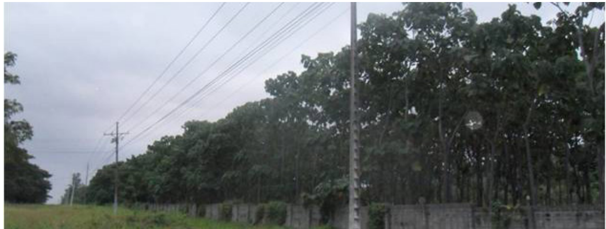
IMAGEN 360: Cableado eléctrico ubicado en el frente del terreno Fuente: Fotografía tomada por Denisse Aguilera
