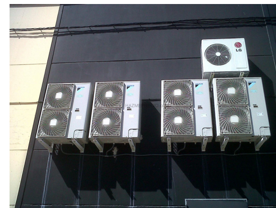
IMAGEN 189: Instalaciones de Split en edificios Fuente: (Airtelec, 2013)
