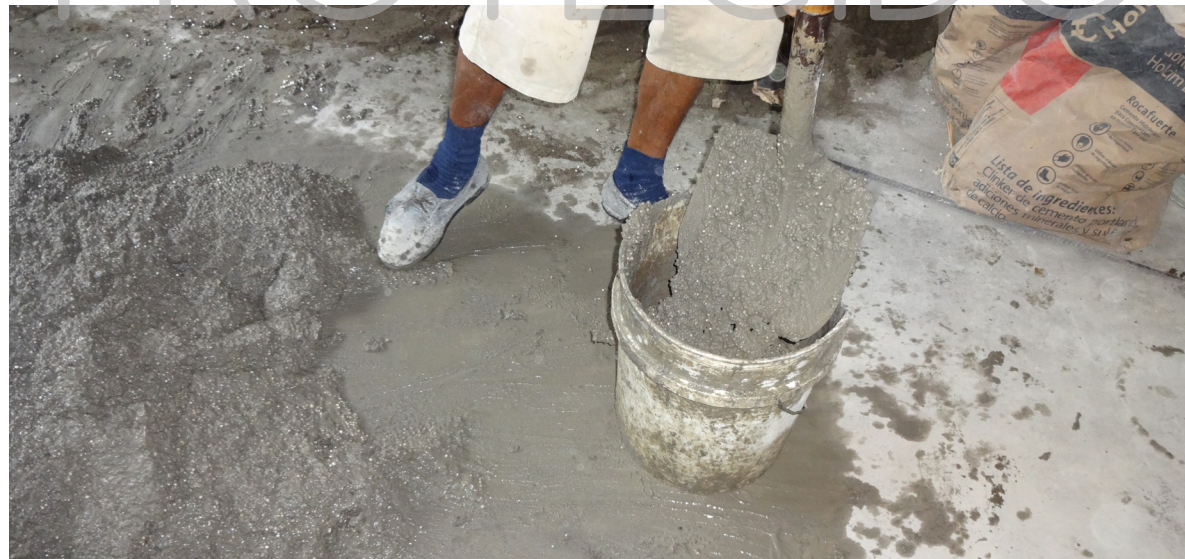
IMAGEN 234: Colocación de la mezcla en tachos para ser llevados al área de encofrado y fundición Fuente: Realizado por Denisse Aguilera
