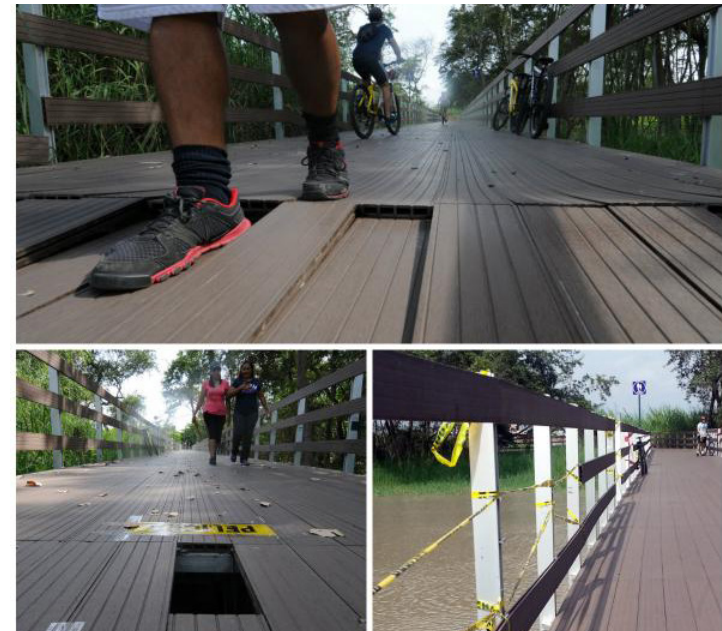
Figura No. 3.23. Daños en la camineras y barandas de la isla Santay
