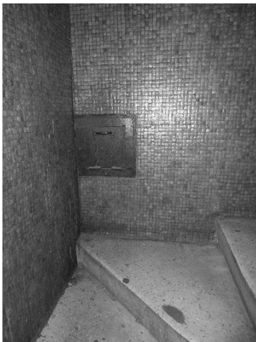
Ilustración 12. Puerta de vertido en áreas de circulación. Edificio Plaza, Ubicado en el centro de Guayaquil. Fuente: Foto tomada por la autora
