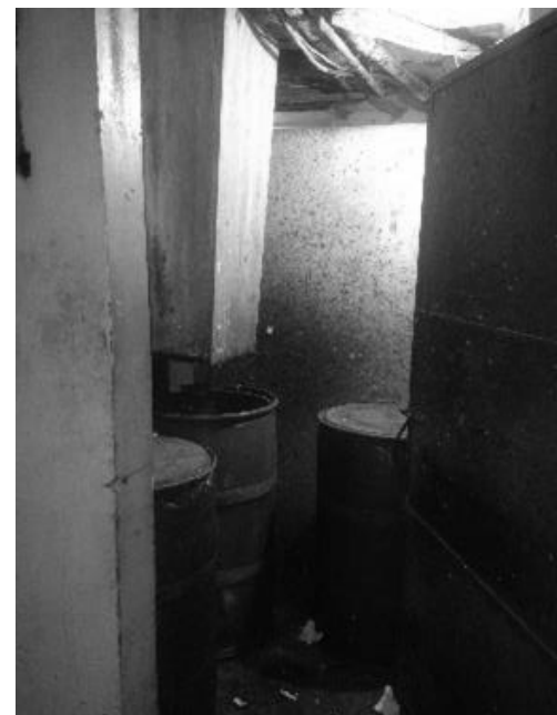
Ilustración 11. Espacio insuficiente para maniobrar el recipiente de recogida, suciedad del cuarto de basura. Edificio Panorama, ubicado en el centro de Guayaquil. Fuente: Foto tomada por la autora
