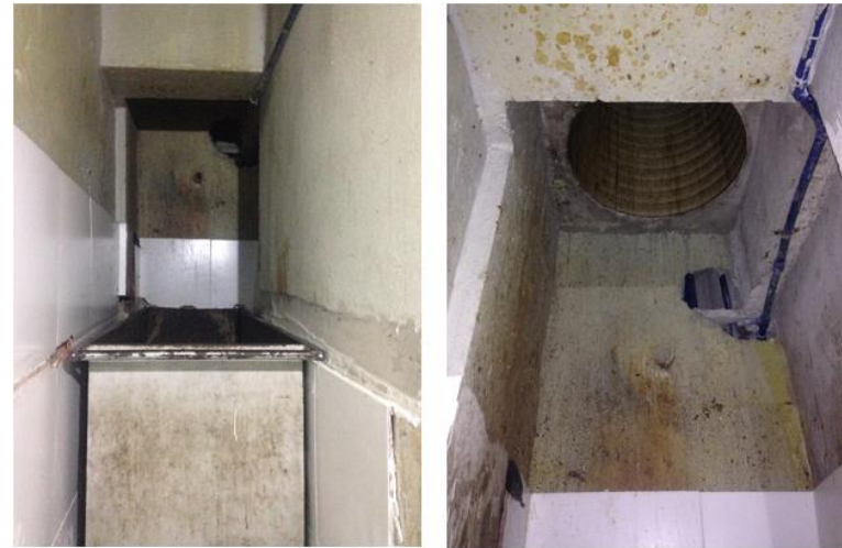
Ilustración 20. Terminación de Ducto. Edificio Scala, ubicado en Samborondón Fuente: Foto tomada por la autora
