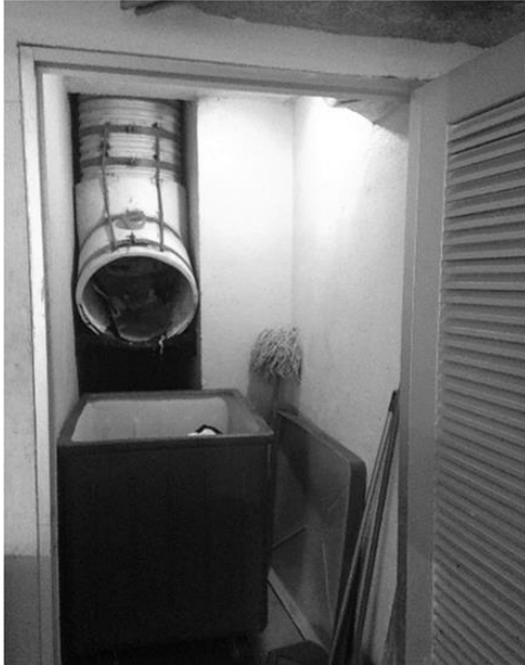
Ilustración 13. Ducto improvisado. Edificio Rio Porto, ubicado en Samborondón Fuente: Foto tomada por la autora
