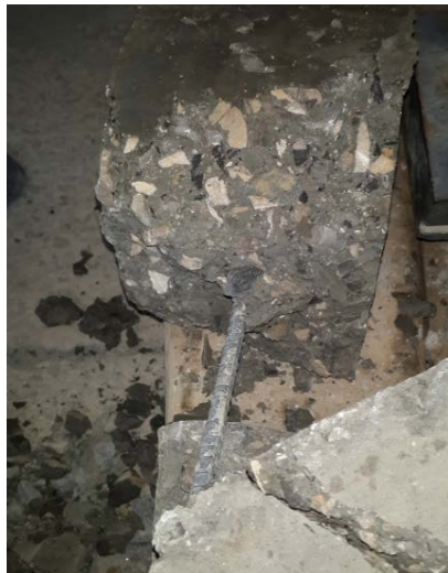
Figure 57 Falla al corte en vigas con 1 varilla
