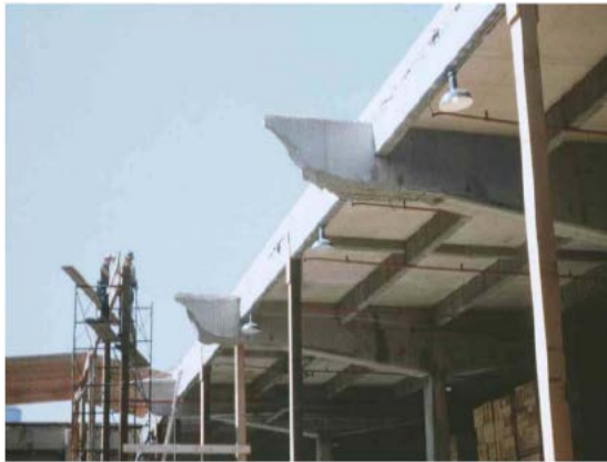
Figure 20 Falla de viga de hormigón armado en galpones de la Fuerza Aérea de Estados Unidos.
