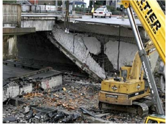
Figure 19 Colapso de viga de hormigón armado debido a la falla por cortante.
