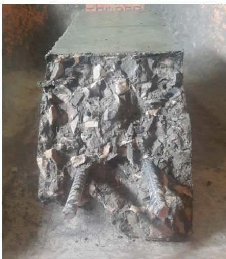
Figure 58 Falla al corte en vigas con 2 varillas
