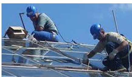
Gráfico 21: Instalación del sistema fotovoltaico
